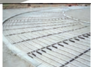
Vytápění příjezdové komunikace
